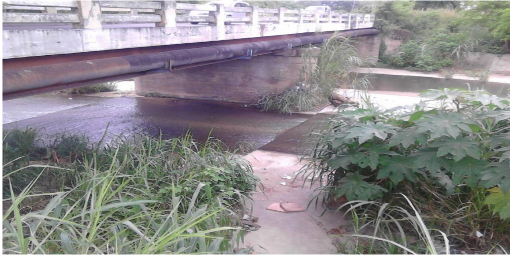
Figura N° 6 Situación actual del puente Av. Bolívar
