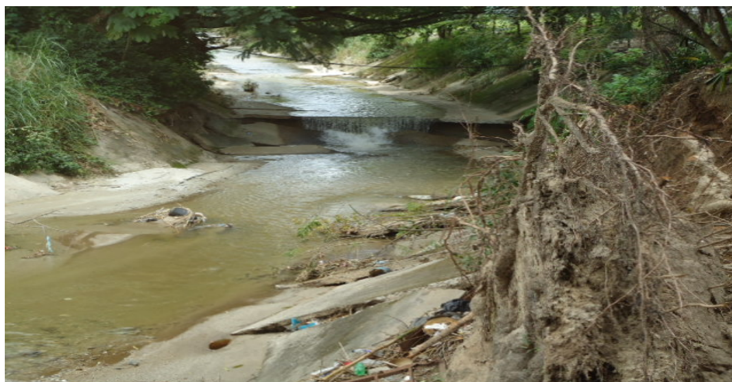
Figura N° 4 Socavación de la canalización
