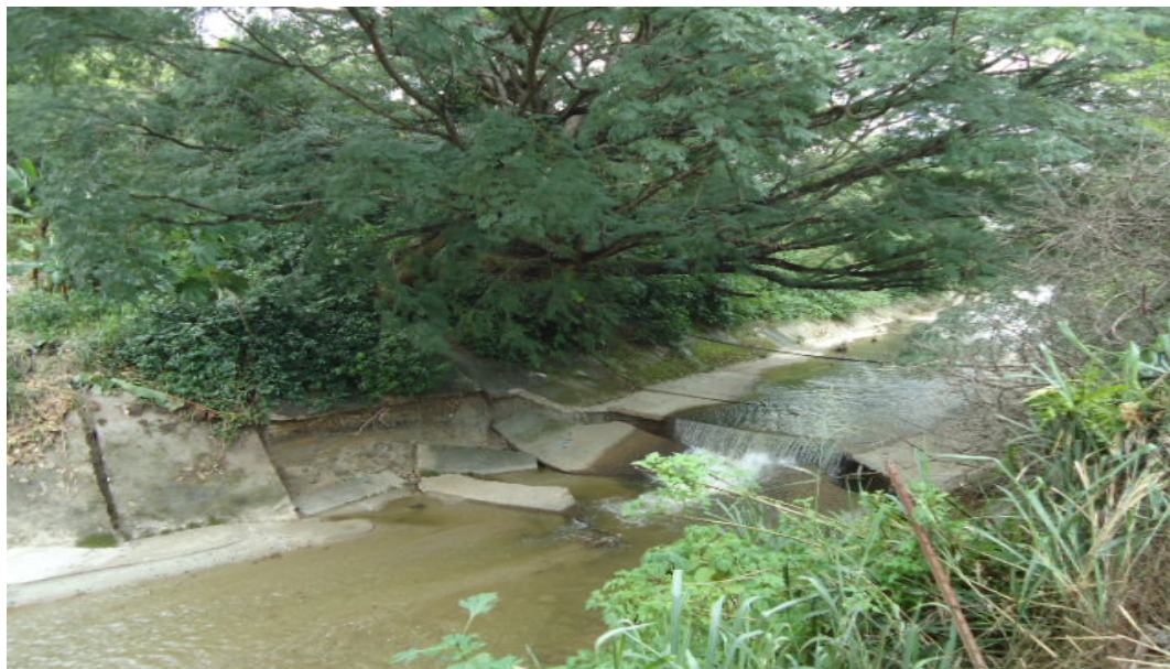
Figura N° 3 Situación actual del tramo final aguas abajo de la canalización de concreto
