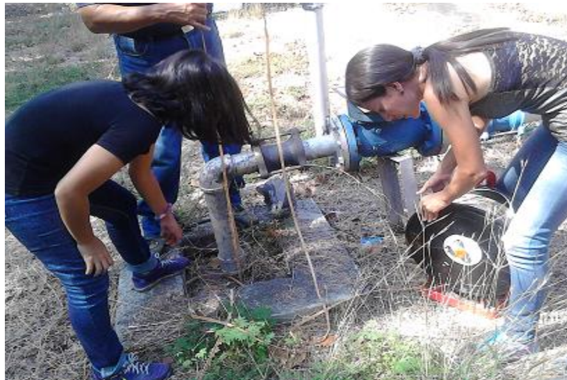
Figura 23. Medición del nivel estático del pozo Morro I, Coordenadas UTM 613566E; 1129798N. Elevación 462 msnm. Zona Centro, Municipio San Diego, Estado Carabobo. Fecha 05/04/2018. Fuente: Los Autores
