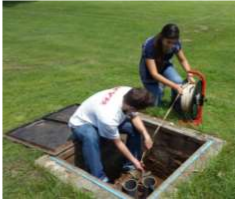
Figura 36 Medición y Lectura de niveles en el Pozo # 3 de Villas de San Diego Country club. Coordenadas 615.974,25 E; 1.137.460,67 N, elevación 495 m.s.n.m, Municipio San Diego, Estado Carabobo. Fecha: 05/09/2016. Fuente: Los Autores.
