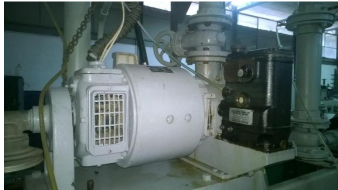
Figura B.3 Generador eléctrico de la turbina Francis del laboratorio de Hidráulica “Elías Sánchez Díaz” de la Universidad de Carabobo.
