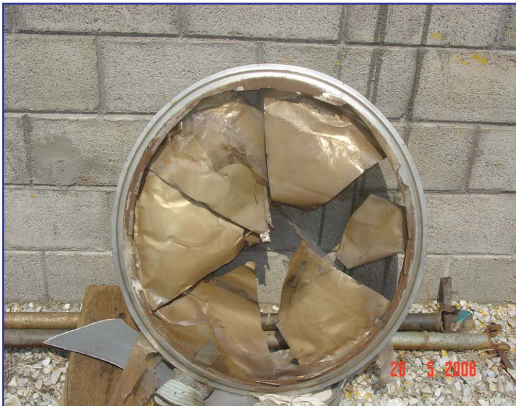
Figura IV.2: Evidencia de exposición de discos de ruptura al fuego. Fuente PDVSA
