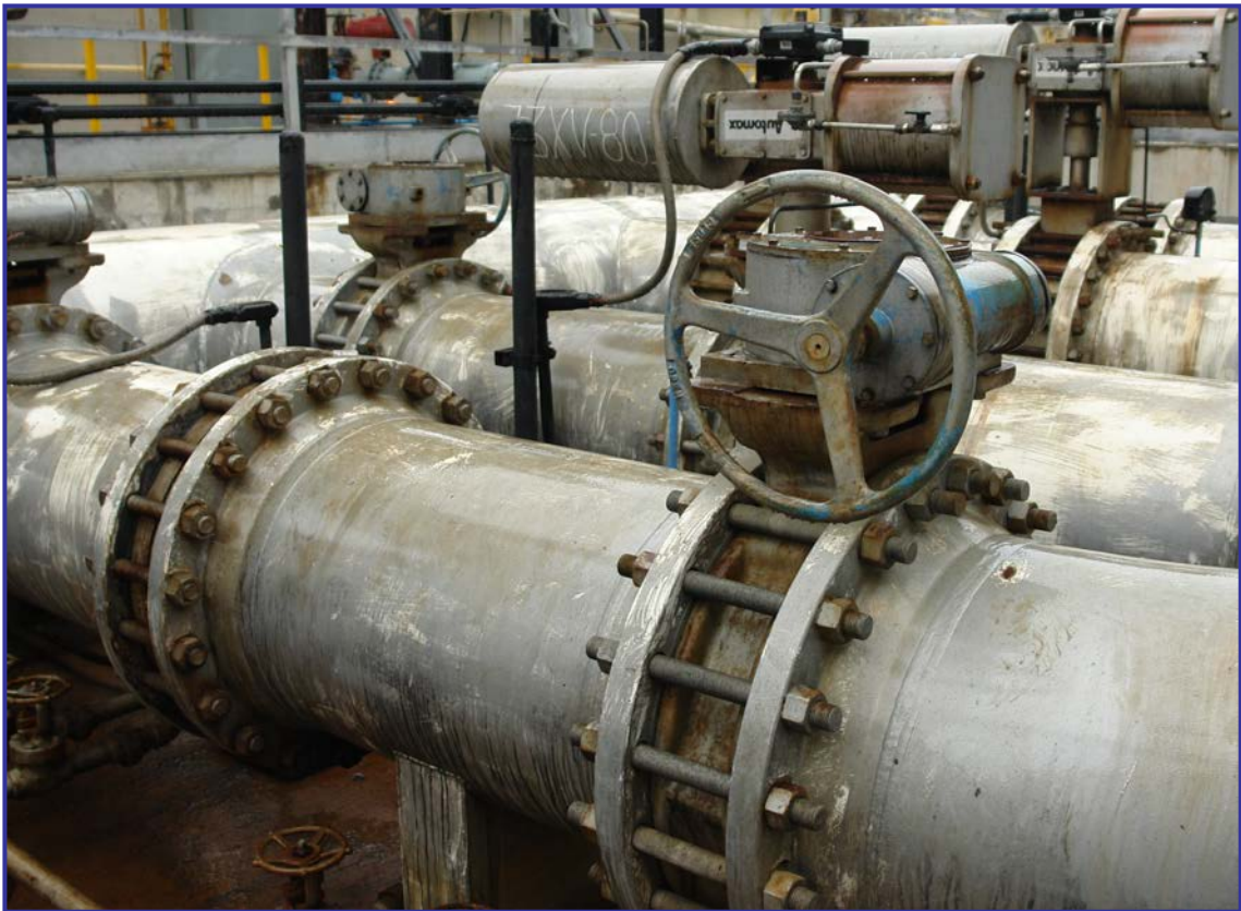
Figura IV.12: Lugar en el que se encuentran instalados los discos de ruptura. Fuente propia
