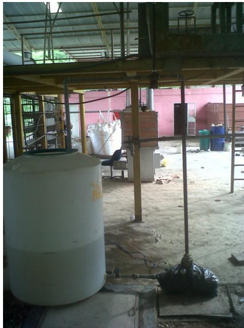
Figura10. Tanque para la recolección de Acido sulfúrico y bomba para recirculación.
