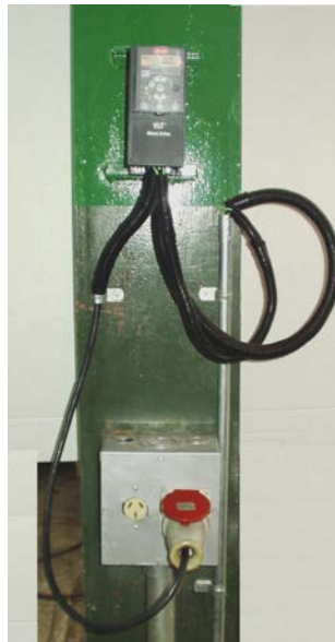
Figura 4-24.- Sistema eléctrico Fuente – Variador de Frecuencia. Fuente: Propia.
