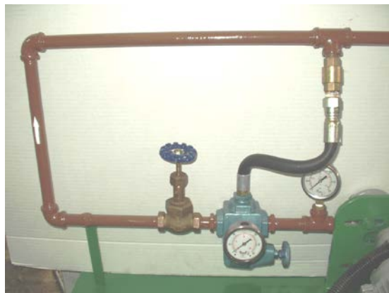
Figura 4-19.- Tramo de descarga, conexiones de las válvulas y los manómetros. Fuente: Propia.
