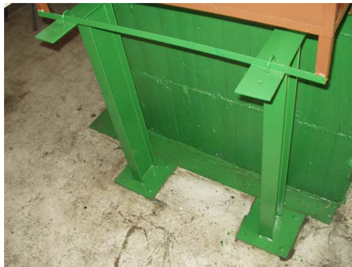
Figura 4-16.- Soporte del tanque (Fijación con pernos de presión). Fuente: Propia.
