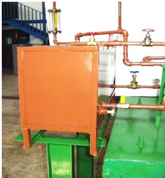
Figura 4-15.- Parte externa del tanque (Fijación con abrazaderas). Fuente: Propia.
