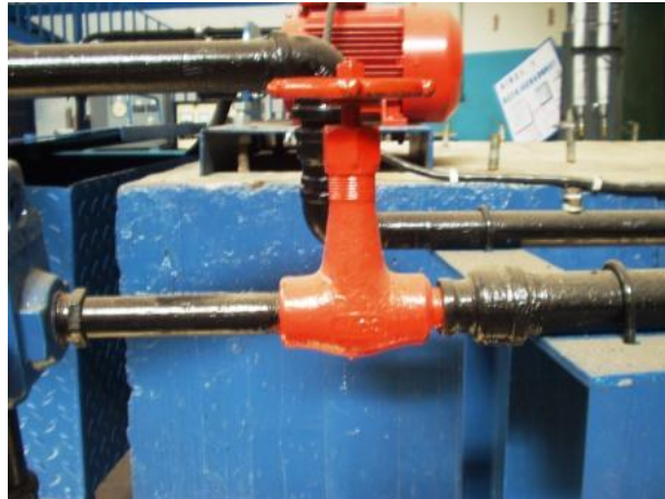
Figura 4-6.- Válvula tipo globo presente en la tubería de descarga del banco de ensayo.
