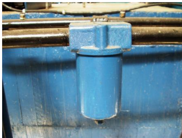
Figura 4-7.- Filtro de línea presente en la tubería de descarga del banco de ensayo.
