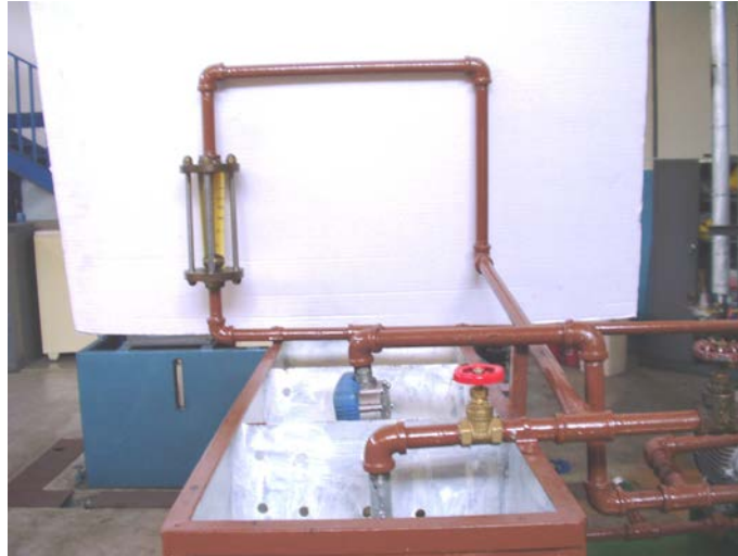
Figura 4-20.- Tramo de descarga, conexiones del rotámetro y desembocadura de tubería. Fuente: Propia.
