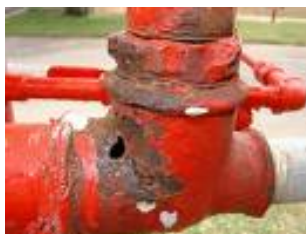
Figura 2.5 Corrosión galvánica en la industria. (TPI. S.A.)
