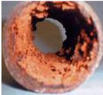
Figura 2.9 Corrosión tipo picadura en la industria. (TPI. S.A.)
