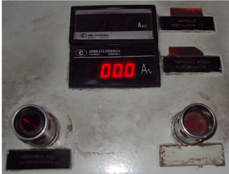
Figura 3.16. Vista de amperímetros digitales y pulsadores de arranque y parada en el tablero de control de CDF. Smurfit Kappa
