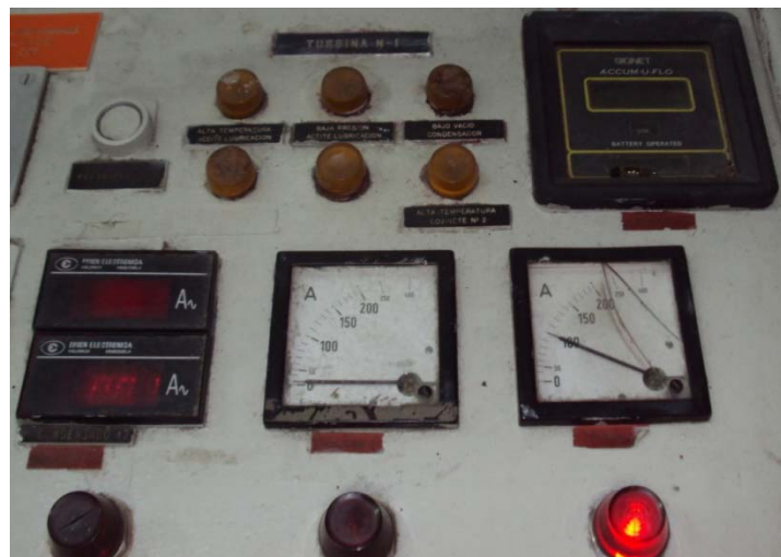
Figura 3. 15. Vista de amperímetros analógicos e indicadores luminosos del tablero de control en CDF. Smurfit Kappa
