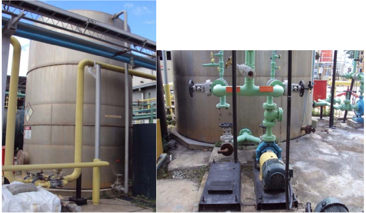
Figura 3. 10. Vista del tanque agua reserva y sus bombas
