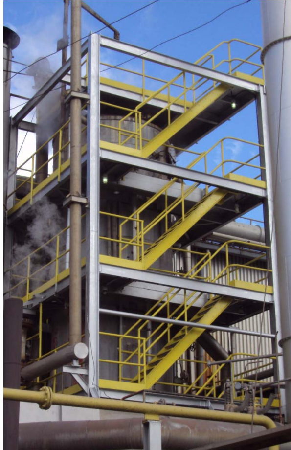
Figura 3. 13. Tanque de alimentación
