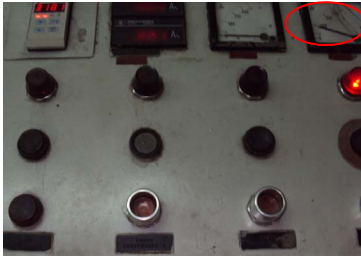
Figura 3. 14. Vista parcial del tablero principal de la sala de control CDF. Sumurfit kappa.
