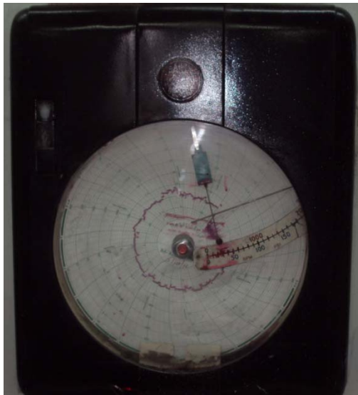
Figura 3. 17. Vista del registrador de flujo de vapor de la turbina No2 CDF. Smurfit Kappa
