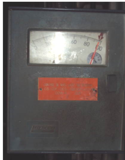
Figura 3. 11. Controlador de nivel del tanque de reserva
