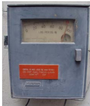
Figura 3. 8. Controlador neumático FOXBORO del tanque de agua potable.
