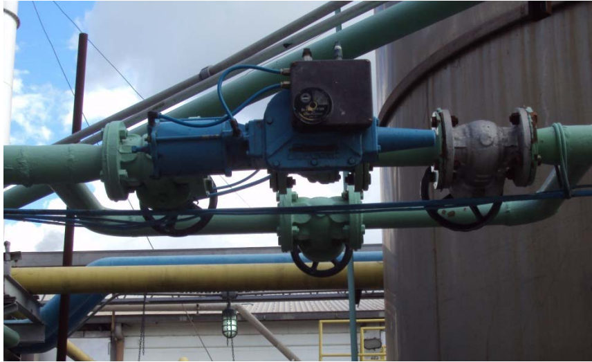
Figura 3. 12. Vista de la válvula de control neumática del tanque de reserva.
