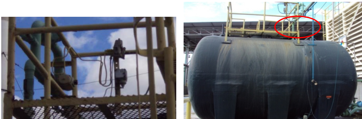
Figura 3. 9. Vista del Tanque de Agua Cruda y Válvula de control neumática
