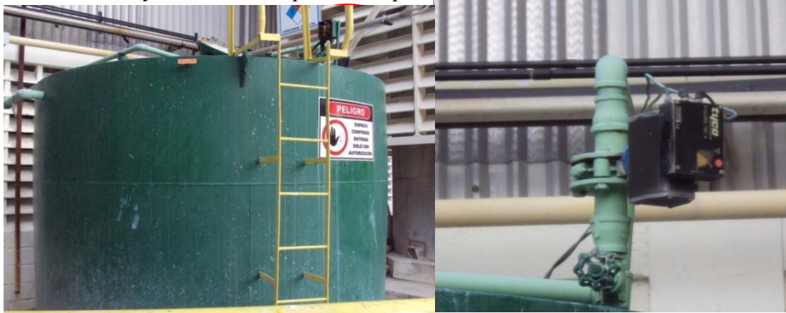
Figura 3. 7. Vista del tanque de agua potable y válvula de control
