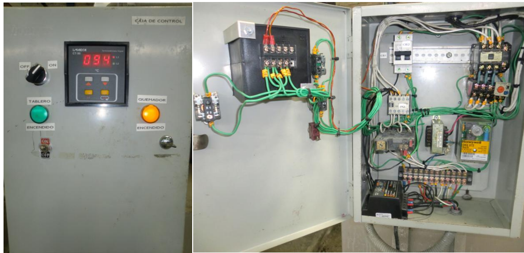
Figura 25: Tablero de horno a gas HOR-01.
