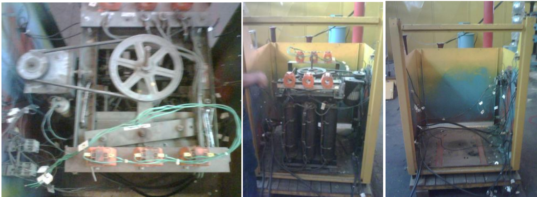
Figura 30: Estado del autotransformador elevador-variador (AEV-01).
