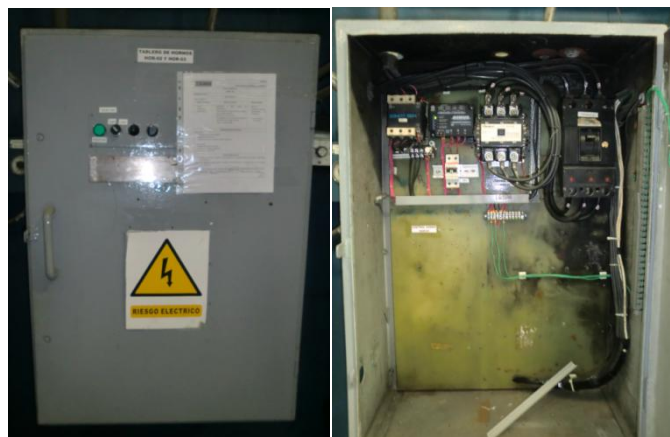
Figura 26: Tablero del horno eléctrico 2 (HOR-04).
