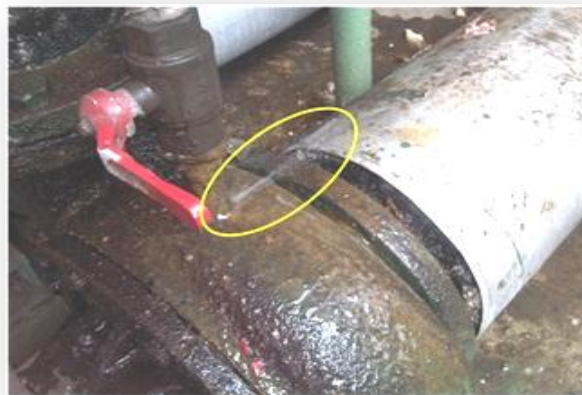
Figura 4.15 Fugas y deterioro de aislamiento térmico en el sistema de tuberías de refrigeración de agua.
