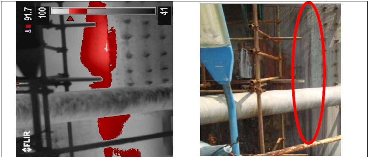
Figura 4.26 Imagen de la Torre de Absorción C-03 muestra incremento térmico en forma vertical descendiente ubicado en la pared cilíndrica lado Este parte superior.
