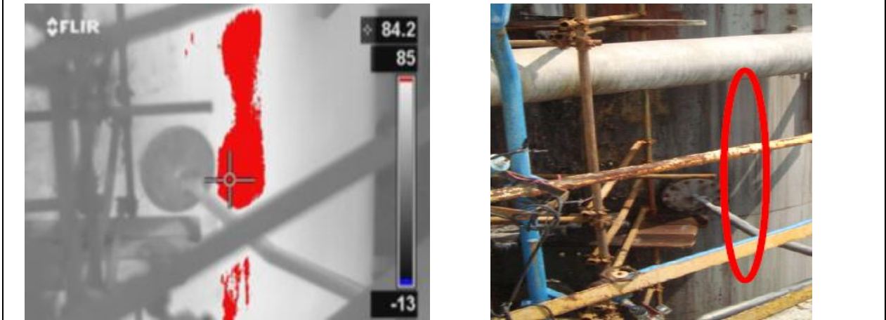
Figura 4.27 Imagen de la Torre de Absorción C-03 muestra incremento térmico en forma vertical descendiente ubicado en la pared cilíndrica lado Este, dicho incremento se extiende hasta la parte inferior.
