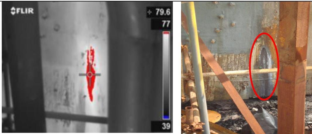
Figura 4.12 Imagen de la Torre de Absorción C-03 leve fuga de ácido en de forma descendente presente en la pared cilíndrica lado Sureste.
