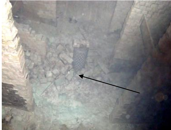
Figura B.4 Desprendimiento de las barras cerámicas de equilibrio entre los portales.
