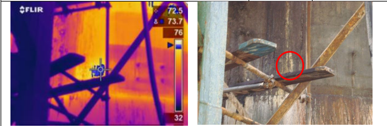
Figura 4.15 Imagen de la Torre de Absorción C-03 incremento térmico que se presenta de forma puntual ubicado en la pared cilíndrica lado Oeste específicamente en el segundo anillo.
