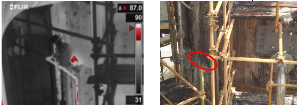
Figura 4.25 Imagen de la Torre de Absorción C-03 muestra incremento térmico encontrado en la adyacencia lado Sureste de la boquilla inferior en la pared cilíndrica lado Sur.
