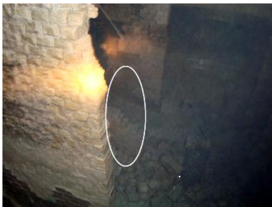
Figura B.1 Desprendimiento del portal de ladrillos.
