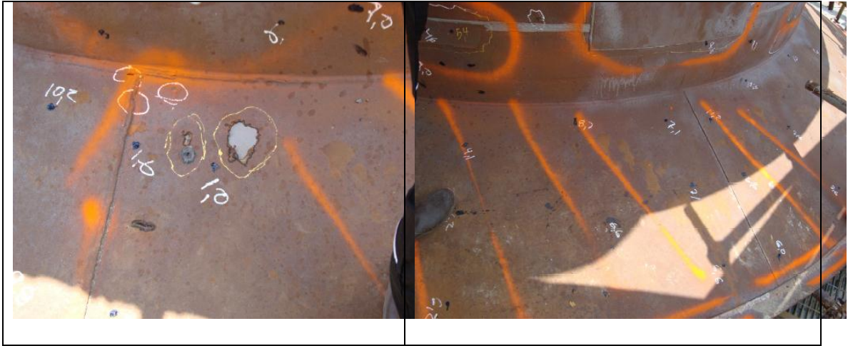
Figura 4.30 Imagen torre absorción C-03 de medición de espesores mostrando valores obtenidos ubicados en la cúpula superior.
