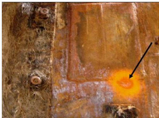
Figuras B.5 Fugas de ácido en la sección de soldaduras de las láminas instaladas a tope.
