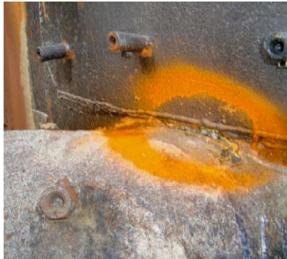
Anexo 6. Imagen torre absorción C-03 inspección visual antes de la medición de espesores, fuga por la soldadura de unión de la manga ubicada en el lado sur-este de la carcaza de la torre.
