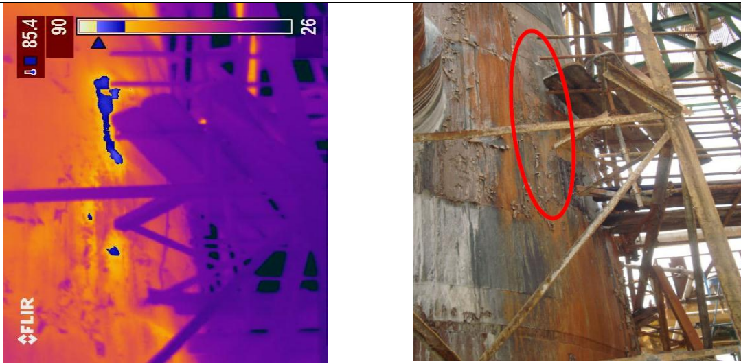
Figura 4.16 Imagen de la Torre de Absorción C-03 incremento de irradiación térmica adyacente a una zona reparada anteriormente.
