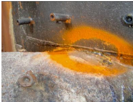
Figura B.6 Fuga por la soldadura de unión de la manga.
