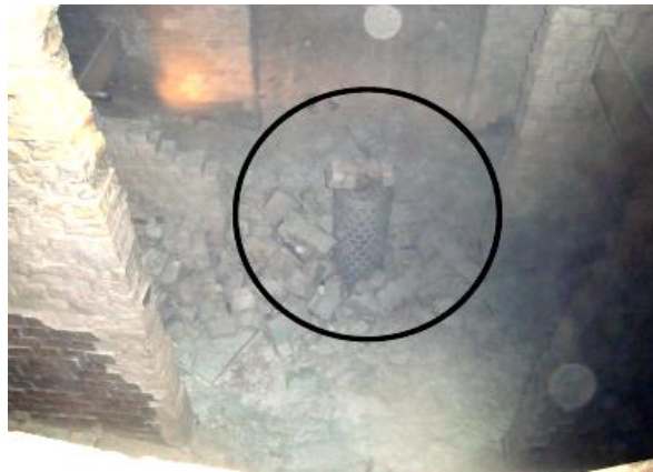
Figura B.3 Obstrucción con ladrillos.
