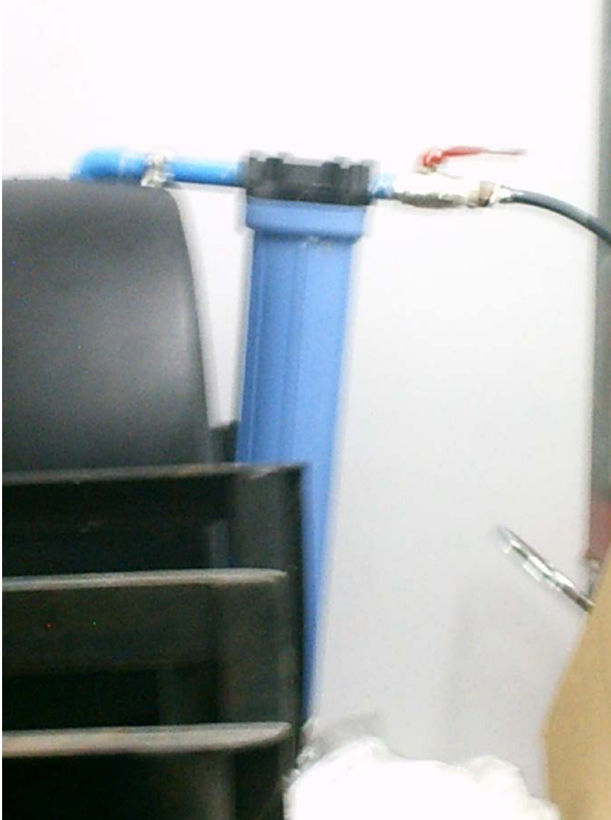
ANEXO #12 CUARTO FILTRADO
