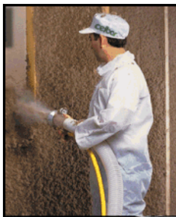
Figura N° 31. Aplicación del K-13
