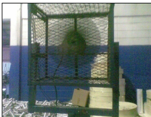
Figura N°5 Ventilador del área.
