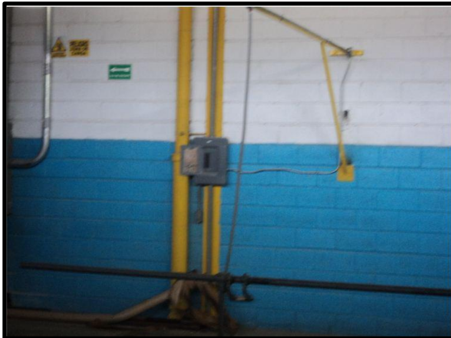
Figura 2-M Condición eléctrica insegura en DPP
