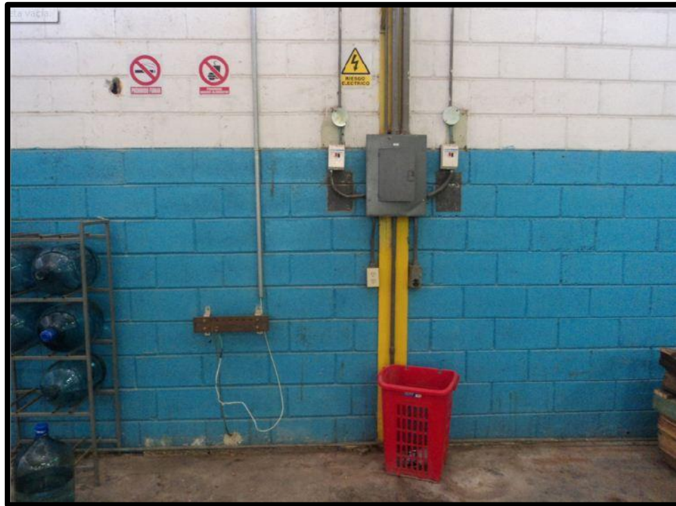
Figura 3-M Ausencia de Señales de Prohibición
