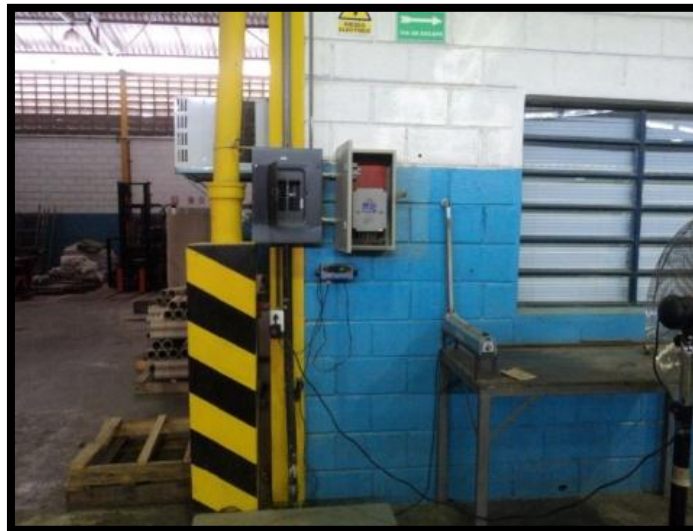
Figura 4.4 Posible Sobrecarga eléctrica, DPP
