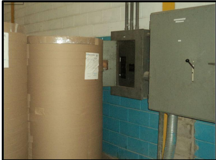
Figura 1-M Condición eléctrica insegura en DMP
