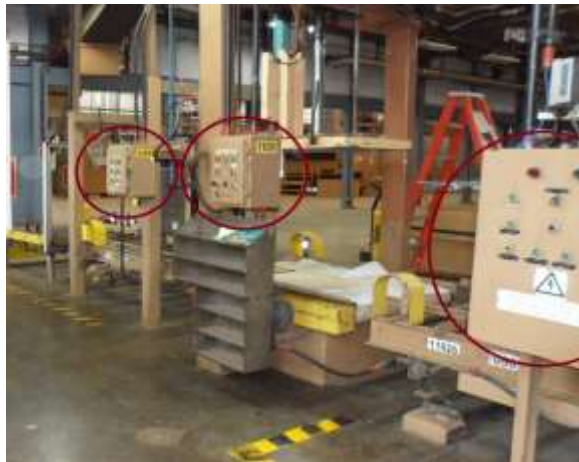
Figura V-8. Ubicación de los tableros de control N°1, N°2 y N°3.
