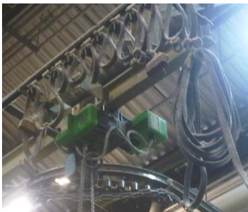
(G). Grúa aérea
