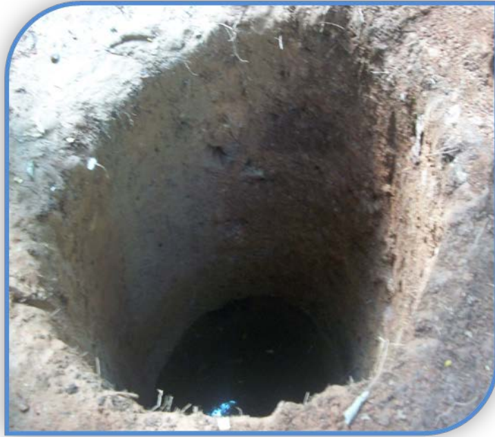
Vista del pozo N° 2 hecho a mano por los miembros de la comunidad Este pozo tiene una profundidad de 120 metros aproximadamente
