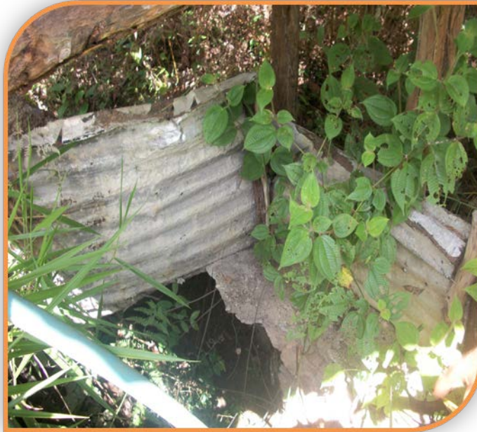
Vista interna del pozo N° 1. Se encuentra inhabilitado debido a un derrumbe en su estructura
