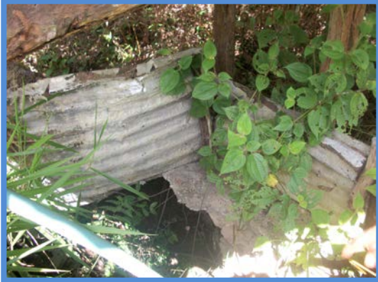
Pozo N° 1 inhabilitado por derrumbe
