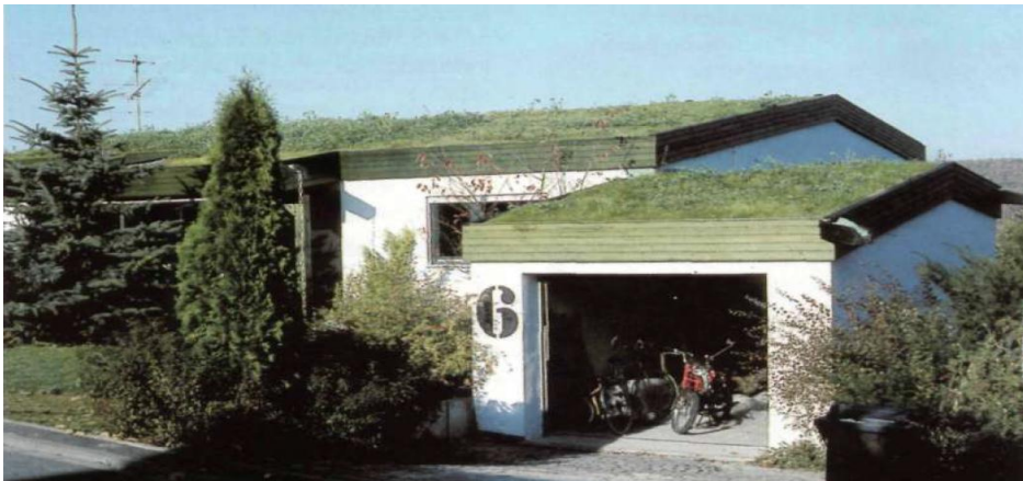
Figura 42: Imagen ilustrativa del sistema de cubiertas vegetales después de ser instalado, en una azotea de pendiente moderada. Gernot, (2007).
