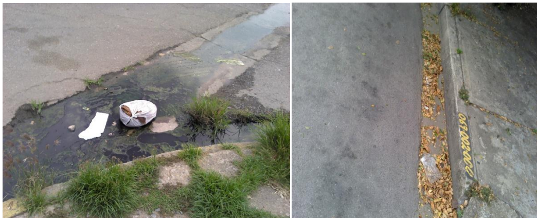
Figura 8: Contaminación difusa presente en el sistema de drenaje urbano que es arrastrada hasta los elementos de captación y en consecuencia ocasiona inconvenientes en el funcionamiento del mismo. Gamboa, (2012).
