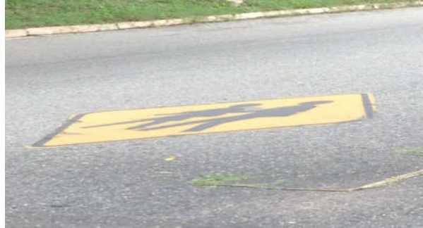
Figura N° 24: Señalización Horizontal de Advertencia de Proximidad del Colegio en la Avenida 88.
