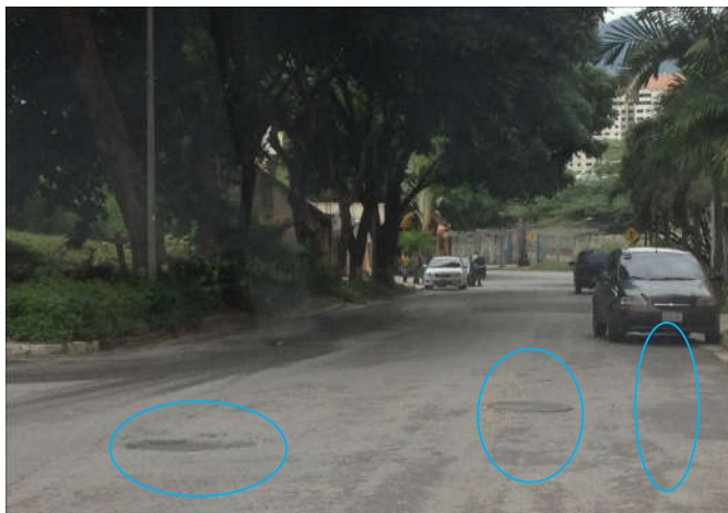
Figura N° 27: Presencia de escombros en el segundo tramo de estudio correspondiente a la calle 126.
