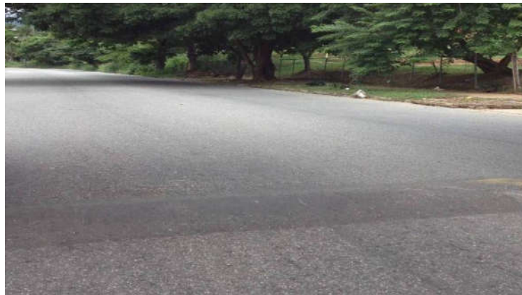
Figura N° 10. Falta De Demarcación Vial en el Primer Tramo de la Calle 126.
