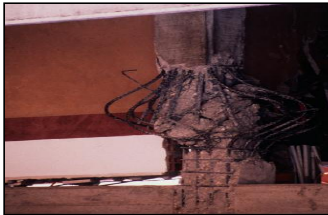
Figura 13: Daños producidos por carga axial en columna. Fuente:cidbimena.desastres_hn/docum/ops/mitigasalu
