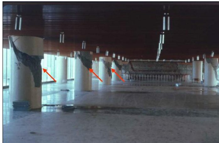
Figura 14: Daños producidos por esfuerzo cortante en columnas del primer piso.
