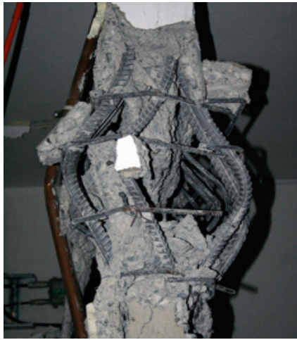
Fotografía 4. Columna con falla. (Fuente: http://ciperchile.cl )
