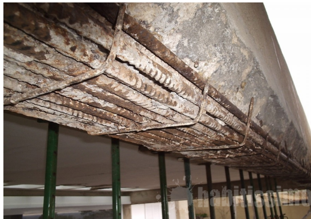
Fotografía 21. Descubrimiento de acero en viga (fuente: narcizobarros.com)
