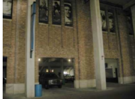
Fotografía 10 . Muros Debilitados. (fuente: Evaluación, reparación y rehabilitación de estructuras de concreto)
