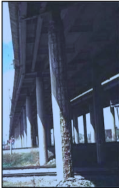
Fotografía 12 .columna deteriorada. (fuente: http://www.quakewrap.com )
