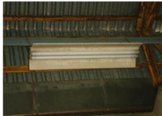
Figura III.18. Lámpara fluorescente dañada.
