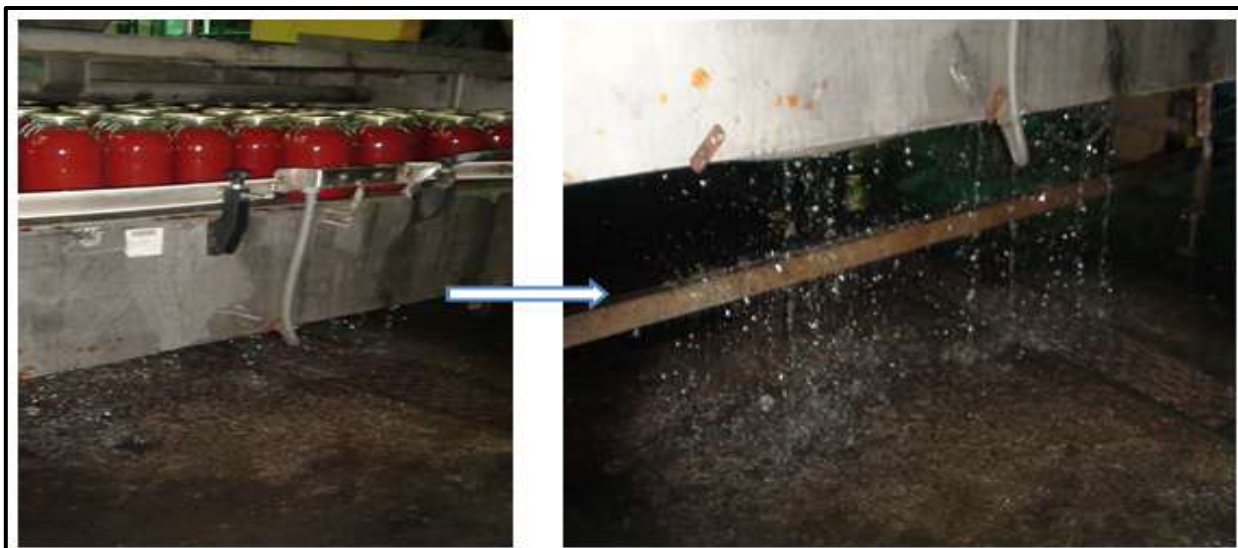
Figura 3.1. Derrame de agua en el pasteurizador de Ketchup Galón.
