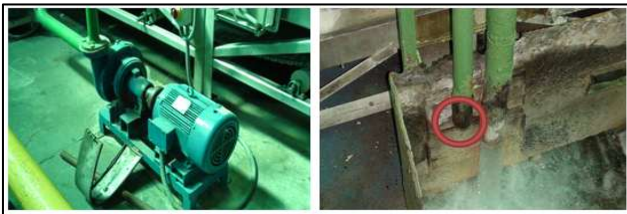
Figura 3.2. Bomba centrífuga de recirculación averiada.
