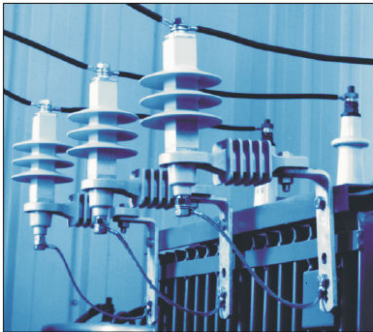
Fig. 2.3.- Descargadores de sobretension colocados en un transformador.
