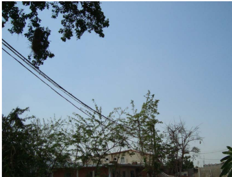
Figura A.3 Estado inicial del sistema eléctrico de una de las calles de Sabana del Medio, San Diego
