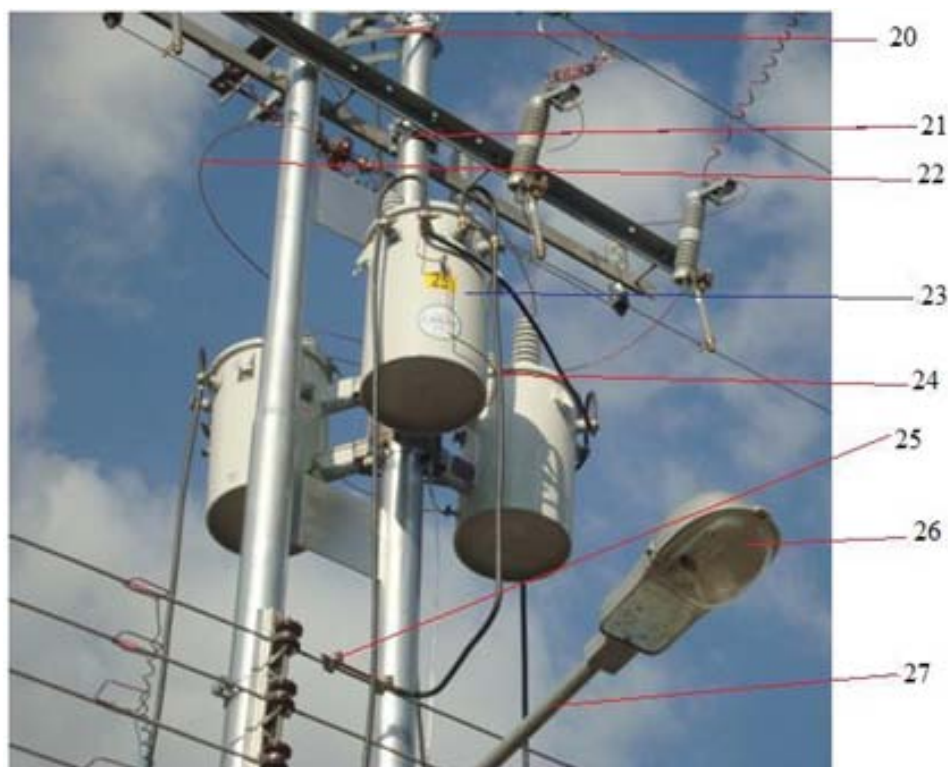
Figura 4.14 Tres Transformadores monofásicos de 25 kVA. Fuente: Fotografía tomada por el autor.
