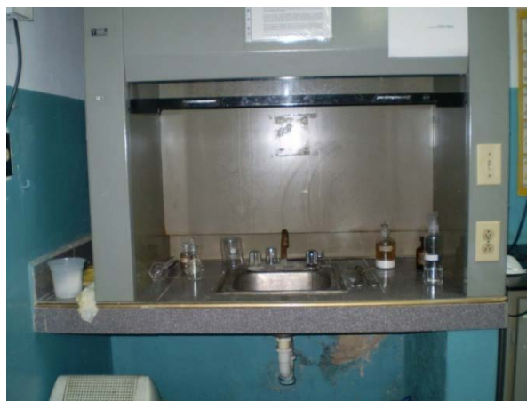
Figura 3.10 Extractora de gases.
