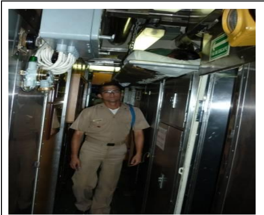
Figura No 2: se observa lo estrecho del pasillo y los equipos en su entorno
